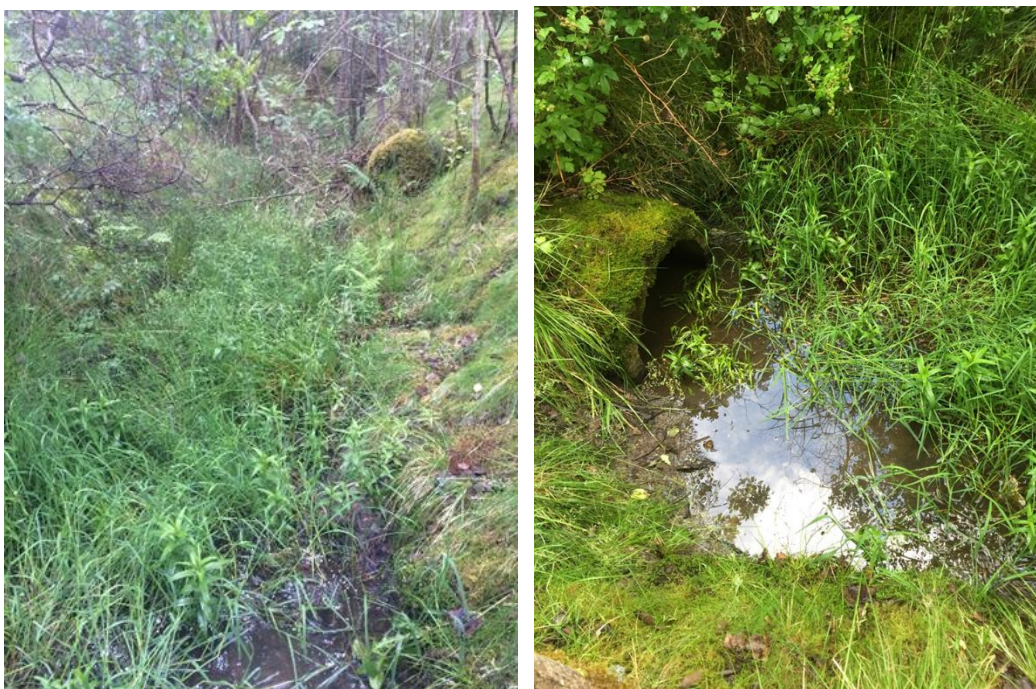
Figur 7. Vänstra bilden: Det djupa diket med inslag av moränstenar i slänterna. Högra bilden: Befintlig trumma söder om elljusspår. Foto: Sweco.
