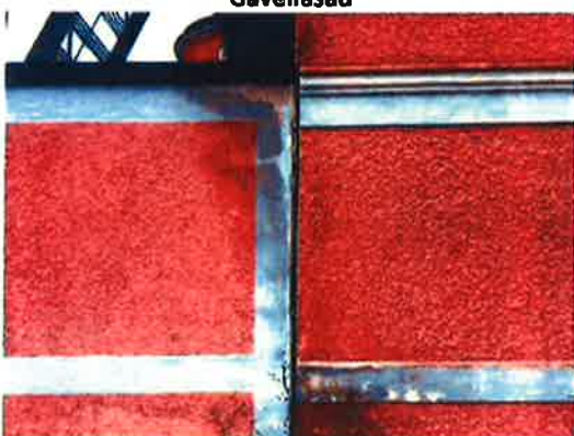
Otät fog mellan byggnad och mur
