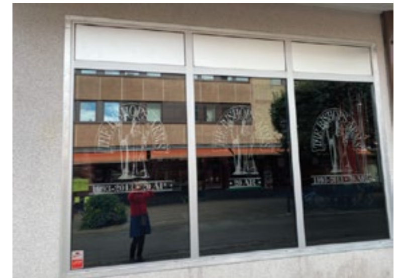
11. Aluminiumparti längs Stora gatan som bör återställas.
